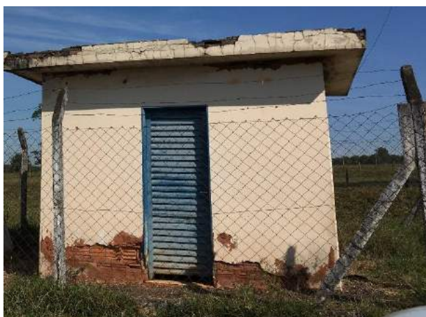
Foto 6.2 – Vista externa da estrutura física de armazenamento de produtos químicos e painel elétrico das bombas
