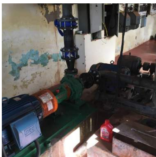
Foto 3.14 - Conjunto motor-bombas da EEAT 01
