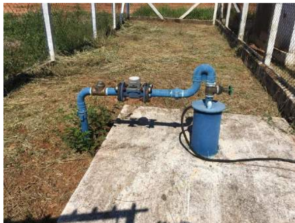
Foto 3.9 - Identificação do Poço: P08
