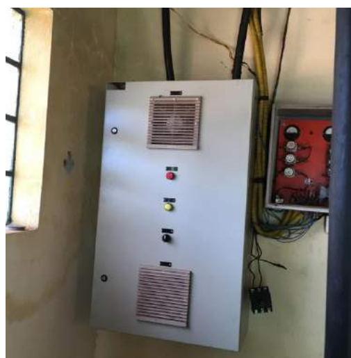
Foto 3.15 – Painel elétrico das bombas da EEAT 01
