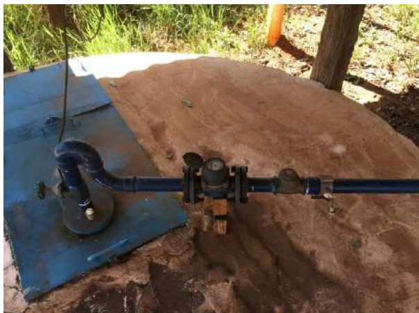
Foto 3.8 - Identificação do Poço: P07
