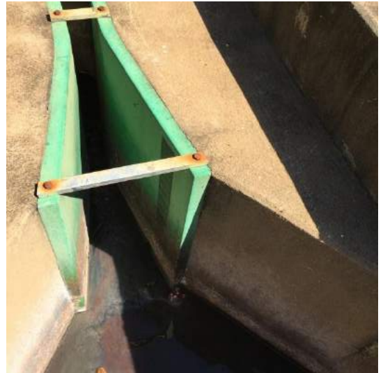
Foto 3.24 – Vista da Calha Parshall EEEB Ipê
