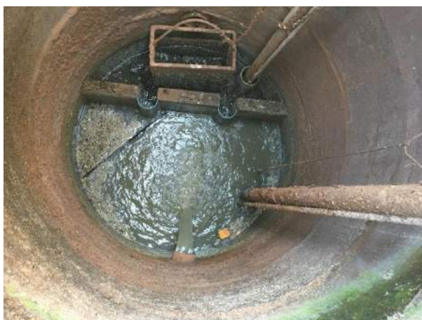
Foto 3.29 – Vista do poço de sucção t EEEB Área de Lazer
