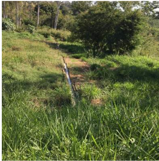
Foto 3.40 – Vista da escada hidráulica ETE Cosmorama
