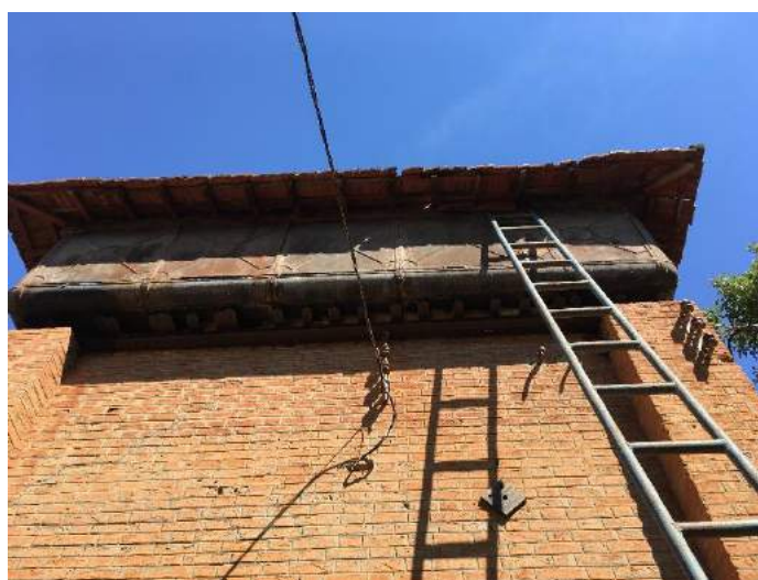
Foto 6.4 – Reservatório do SETOR 02- Estação em estado precário
