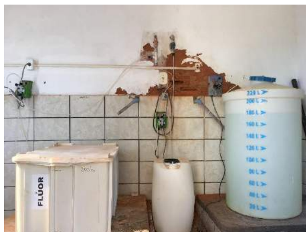
Foto 6.3 – Vista interna da estrutura física de armazenamento de produtos químicos e painel elétrico das bombas
