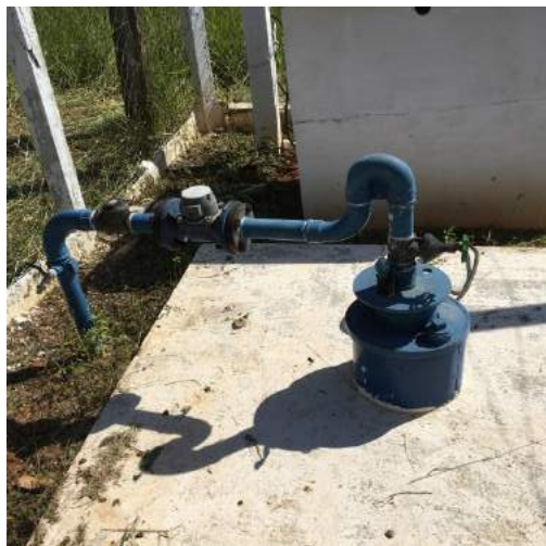
Foto 3.2 - Identificação do Poço: P01
