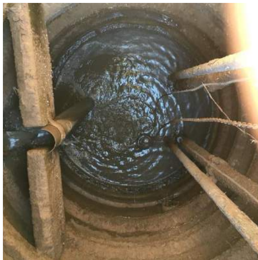
Foto 3.34 – Vista do poço de sucção EEEB Belim
