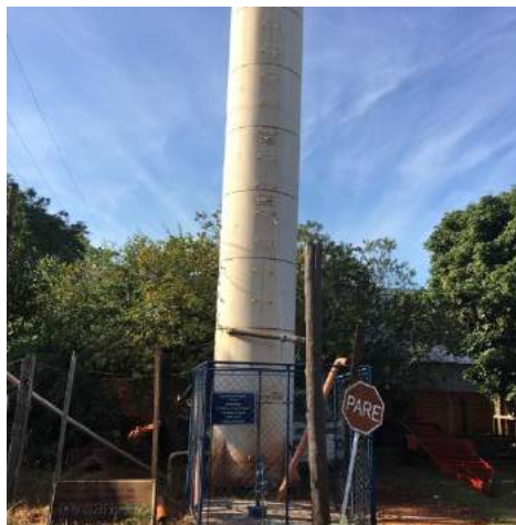
Foto 3.22 - Identificação do Reservatório: RAP 05
