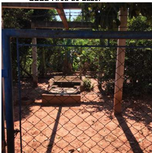
Foto 3.31 – Vista geral das unidades EEEB CDHU
