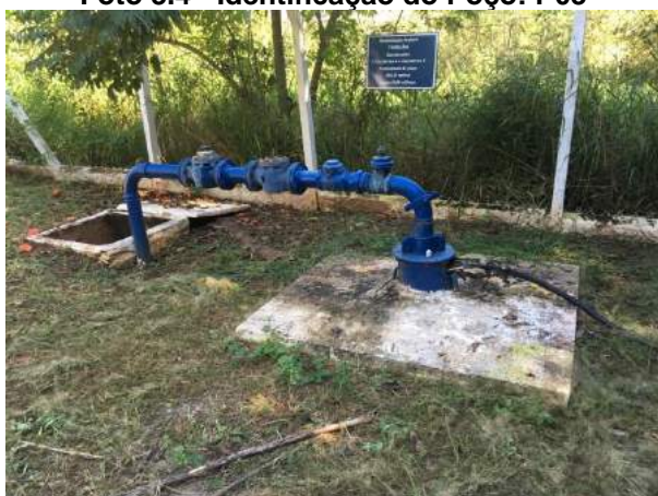
Foto 3.6 - Identificação do Poço: P05
