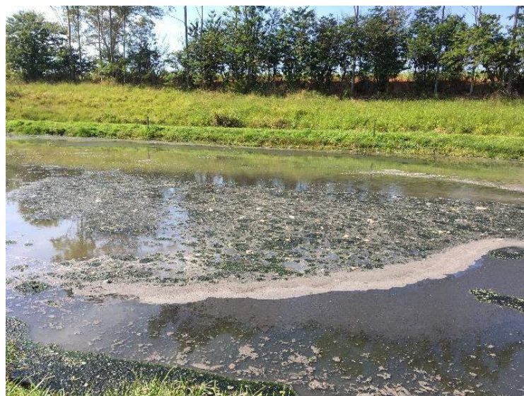
Foto 6.6 – Vista da presença de sobrenadante e placas de lodo desprendido do fundo na superfície líquida da lagoa anaeróbia
