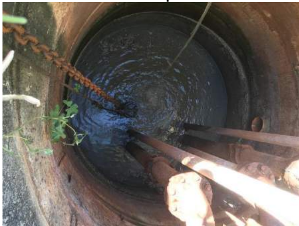
Foto 3.25 – Vista do poço de sucção EEEB Ipê
