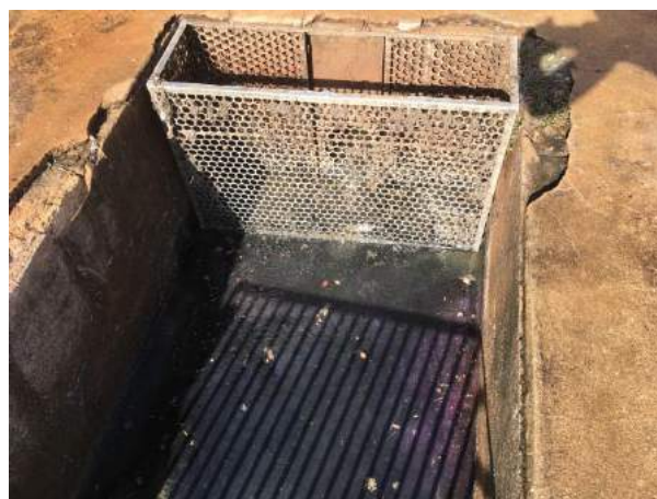
Foto 3.42 – Detalhe do cesto na chegada do emissário ETE Vila Nova
