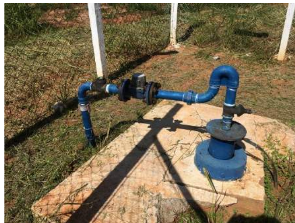
Foto 3.3 - Identificação do Poço: P02
