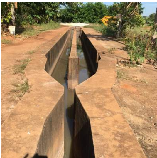
Foto 3.36 – Vista geral do tratamento preliminar ETE Cosmorama
