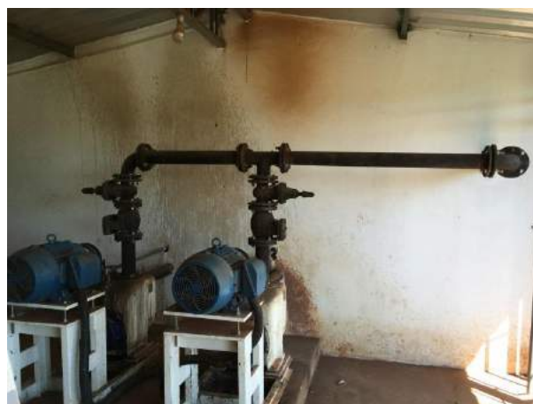
Foto 3.30 – Vista dos conjuntos motor-bombas EEEB Área de Lazer
