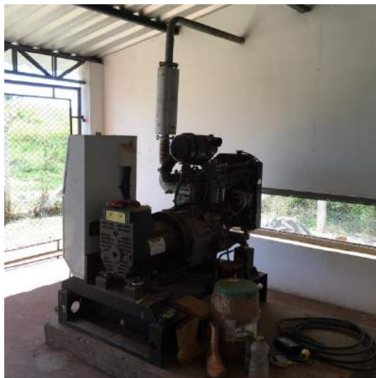
Foto 3.28 – Vista do gerador de energia EEEB Área de Lazer
