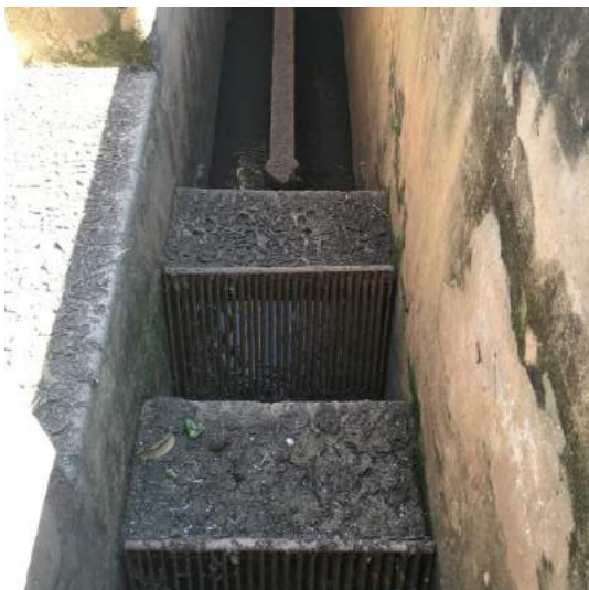
Foto 3.33 – Vista do tratamento preliminar EEEB Belim
