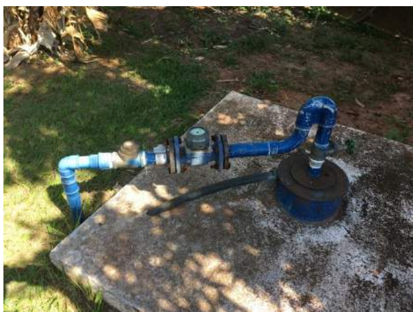
Foto 3.10 - Identificação do Poço: P09
