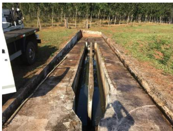
Foto 3.41 – Vista geral do tratamento preliminar ETE Vila Nova
