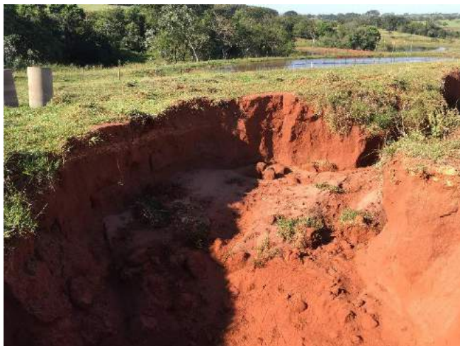
Foto 3.72 – Erosão na propriedade particular
