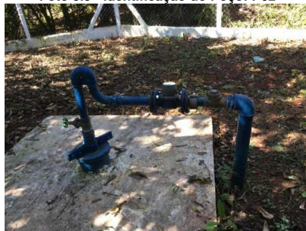
Foto 3.5 - Identificação do Poço: P04
