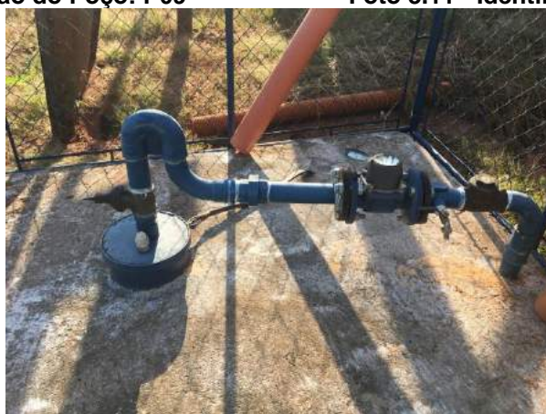
Foto 3.12 - Identificação do Poço: P11
