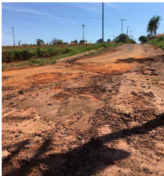
Foto 3.70 – Erosão Rua José Sanches Parra
